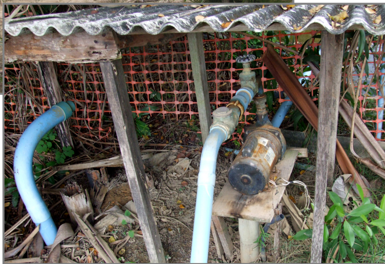
Acima: tanque d'água de 510.000 litros; no meio: viveiro sombreado; abaixo: bomba d'água no poço artesiano de 50 metros de profundidade
