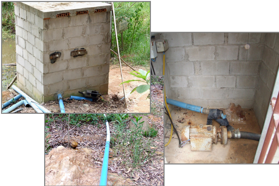
Casa da bomba d'água e tubulações na borda da represa
